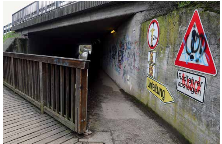
Das müsste niemandem mehr zugemutet werden, wenn „RTW PLUS“ realisiert wird: die dunkle, enge, schmutzige Unterführung unter der A66 zwischen Sulzbach und Sossenheim, auf der sich Radfahrer und Fußgänger im Hundekotgeruch aneinander vorbeizwängen.
