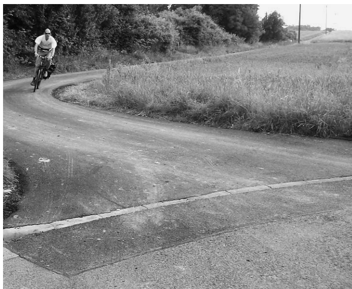
Wegausbau Oberursel - Bad Homburg: Bordsteinkante wurde zuasphaltiert, so dass auch hier ein schlagfreies Fahren möglich ist.
