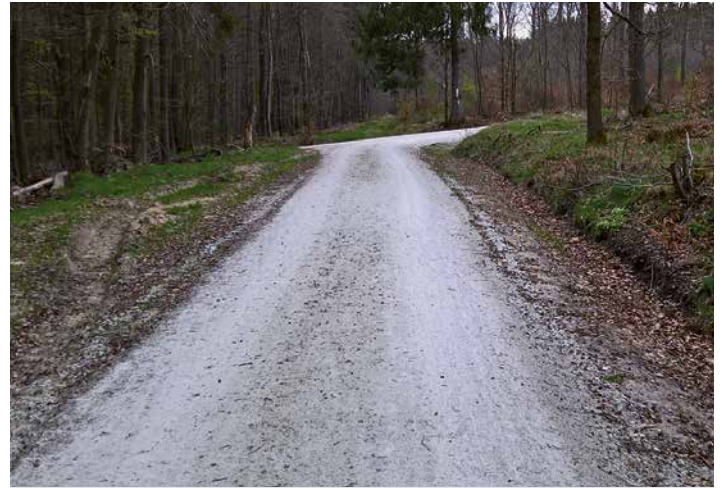
Zwischen Wehrheim und der Saalburg wurde im Wald die Wegoberfläche mit weißem Quarzitsand erheblich verbessert
