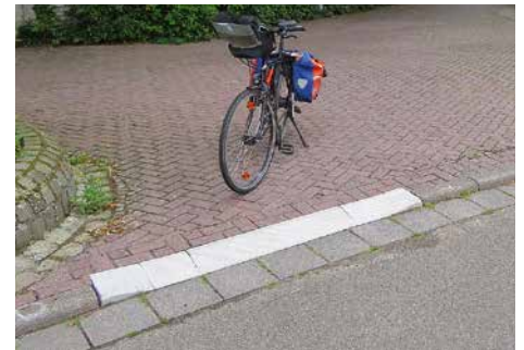
Bordsteinabsenkung an Einmündung des Hermann-Löns-Wegs auf die Feldbergstraße
