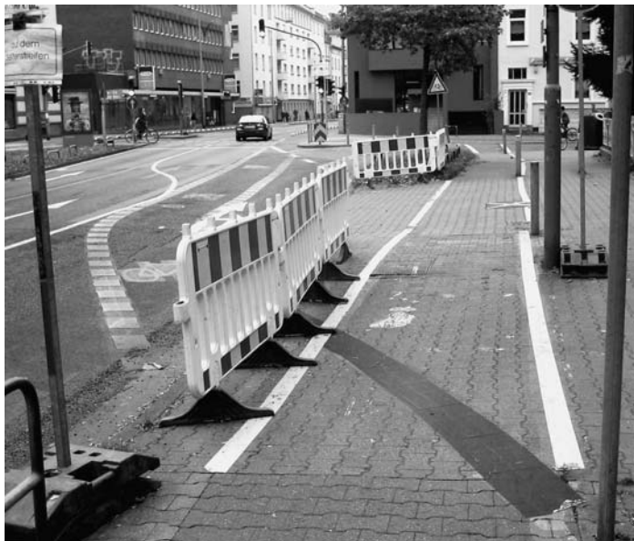
Die Fahrrad-Piktogramme vor der Burgstraße werden zurzeit vom Kraftfahrzeug-Verkehr auf der Rothschildallee überfahren. Zu erkennen ist die (verspätete) Markierung des Radstreifens über den Fußweg. Foto: (ps)
