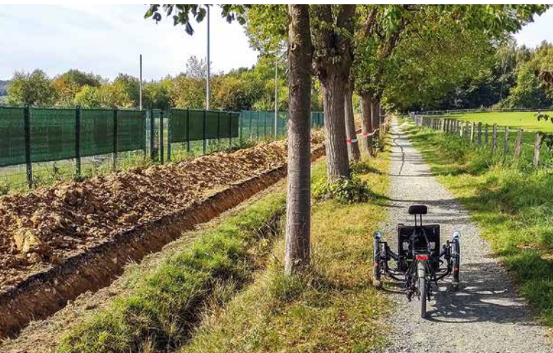
Der asphaltierte Weg links im Bild war längere Zeit über die gesamte Länge aufgedrückt und unpassierbar. Auf dem Schotterweg nebenan war Radfahren verboten.
