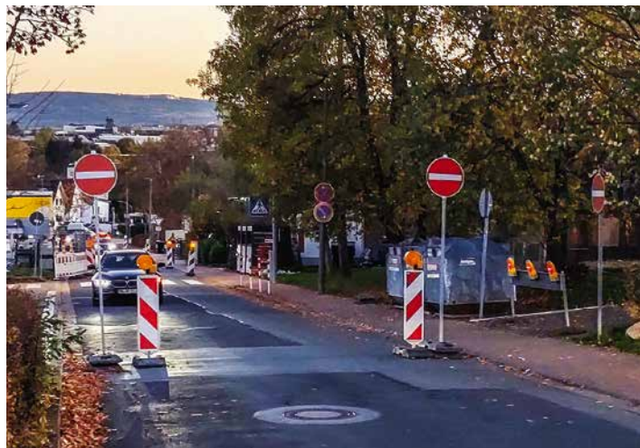
Wilhelm-Martin-Dienstbach-Straße in Usingen. Situation von Norden kommend: Verbot der Einfahrt ohne Umleitung. Platz wäre genug für eine Freigabe.
