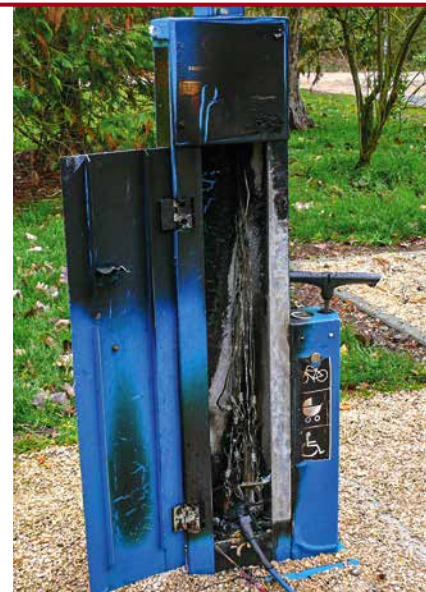
Die zerstörte Station im Burgpark – ein Bild des Jammers Theo Sorg
