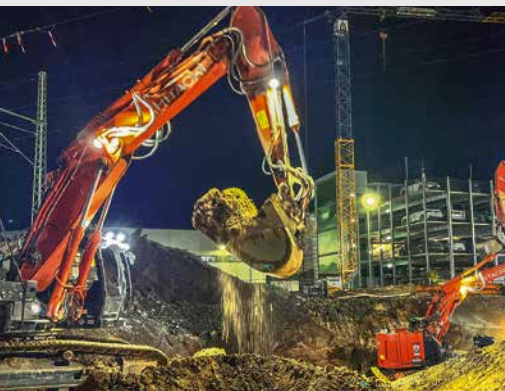
Gebaggert wird rund um die Uhr, der Zeitplan ist knapp bemessen Falko Görres (4)
