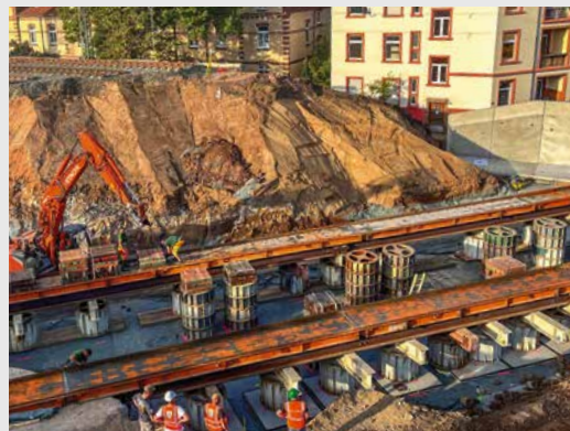
Auf „Schienen“ wird der vorgefertigte Tunnel in die Lücke im Homburger Damm geschoben
