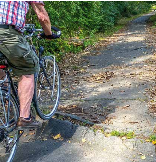
Wurzelaufbrüche auf dem Weg durch den Fechenheimer Mainbogen
