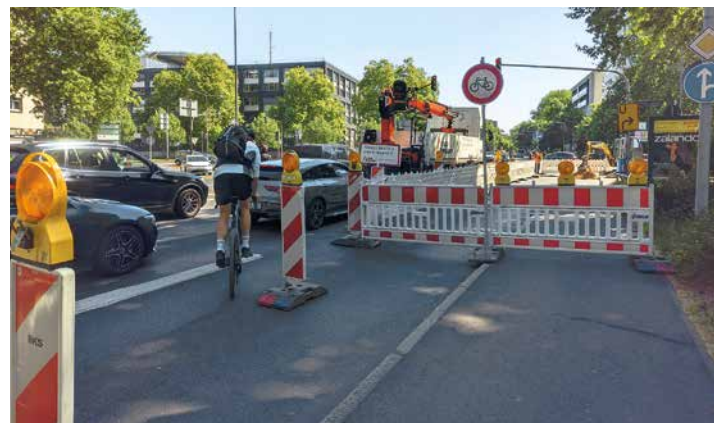
Hier geht es nur auf der Fahrbahn mit dem Kraftverkehr weiter.
